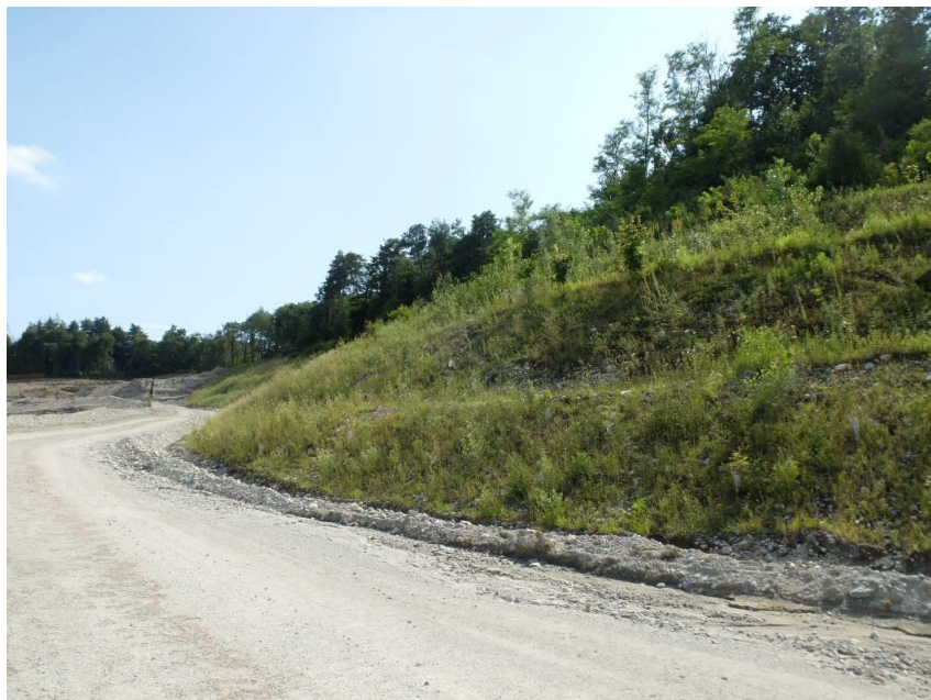
Figura 6.5 : Scarpate ripristinate, nella fascia ovest di Faraona, oggetto dei rilievi
